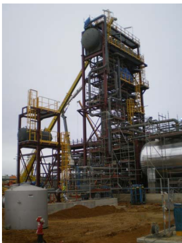
Estructura Soporte Tanque Expansión
