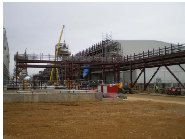
Racks y Edificio de Turbina
