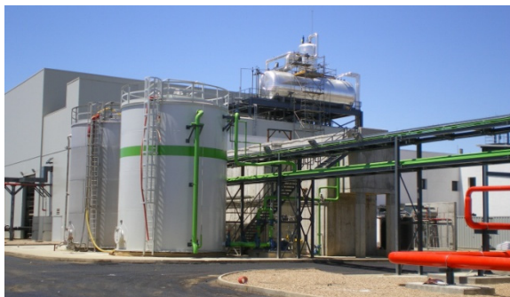
Nave turbinas y edificio eléctrico
