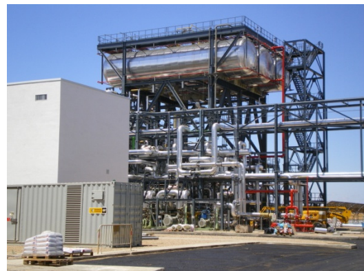
Vasos de expansión y racks
