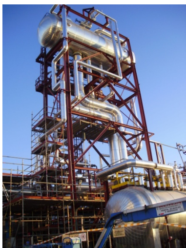
Estructura Soporte Tanque Expansión
