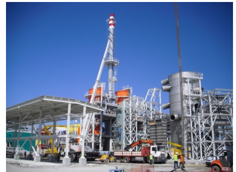
Área del Reactor
