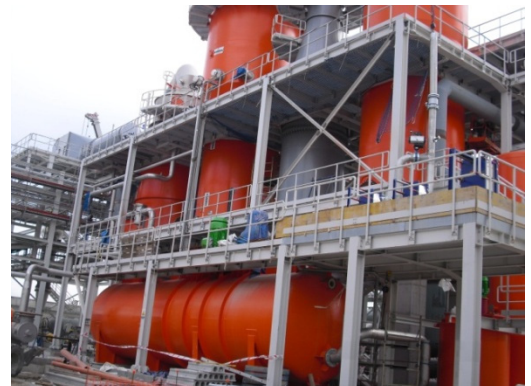
Tanques y Filtros
